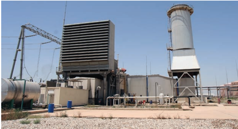
Site Photo 8. General Electric Frame 9E turbine unit.
