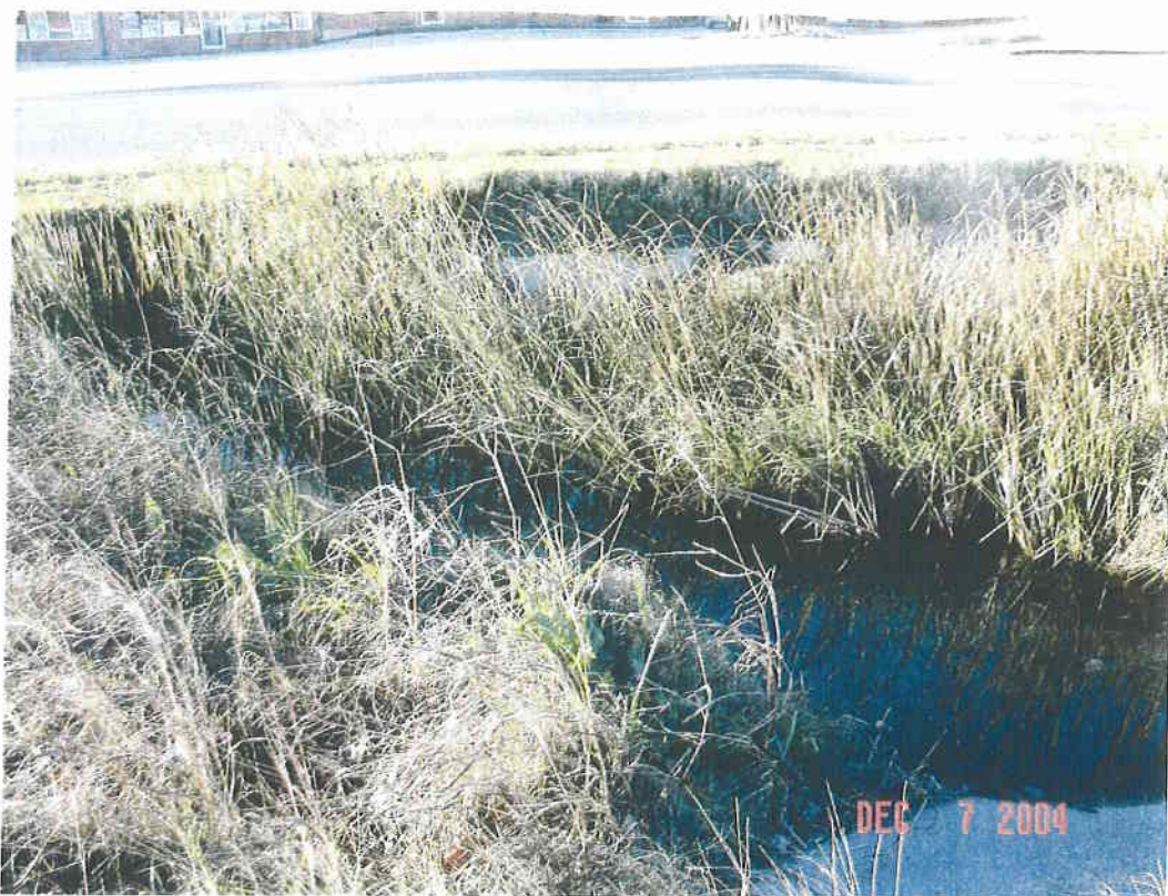
Rancier Ave storm sewer discharge
