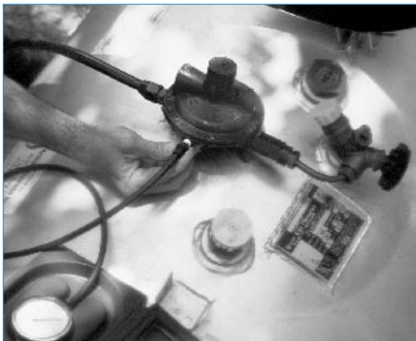
Técnicos en propano que realizan una prueba para detectar fugas.
