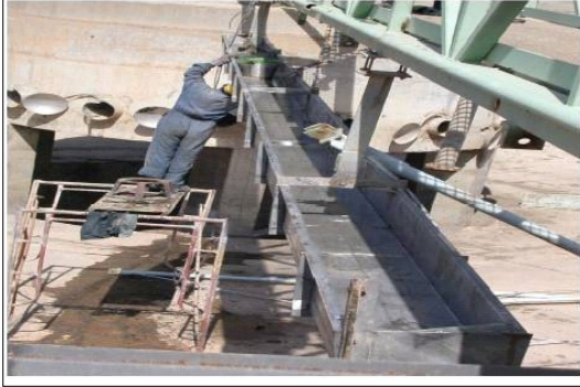
اصلاح المقشدة في عملية التثبيت الاولى للخزان في مشروع شمال الرستمية ، وهو احد ثلاث مشاريع رئيسية لمعالجة المياه الثقيلة في بغداد.
