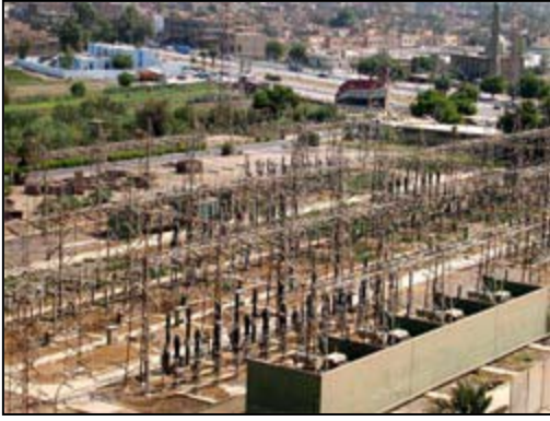
مشروع الدورة للطاقة الكهربائية. الصورة: USAID
