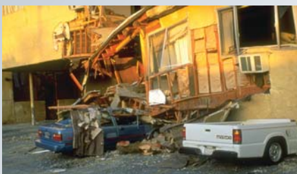
El primer piso de este edificio se derrumbó, aplastando los autos debajo. (Foto FEMA)
