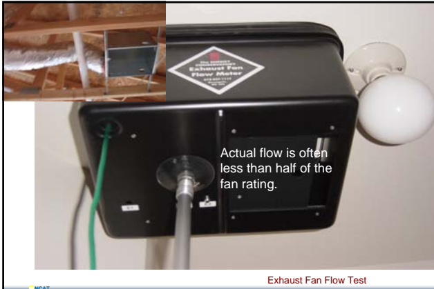
Exhaust Fan Flow Test
