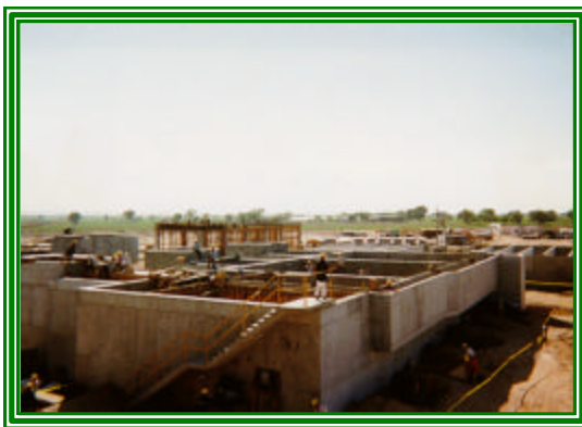
Planta de Tratamiento de Aguas residuales del Sur en Ciudad Juárez, CH, México.
