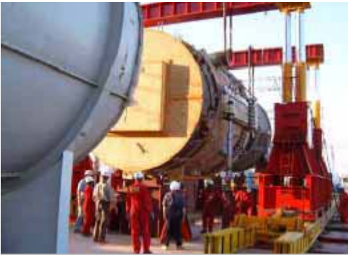
يتم تنصيب المحرك ذو الاحتراق الغازي V-94 في محطة كركوك الثانوية وبالشراكة مع V-64 سيتم اضافة 325 ميغاواط الى شبكة الكهرباء الوطنية.
