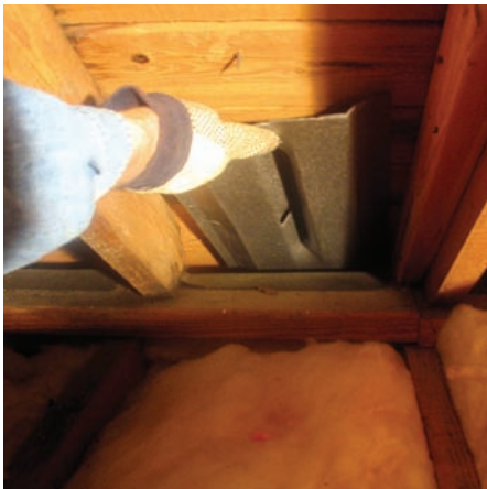
Coloque las láminas de ventilación entre las maderas donde el techo se encuentra con el suelo. Foto cortesía de Doug Anderson
