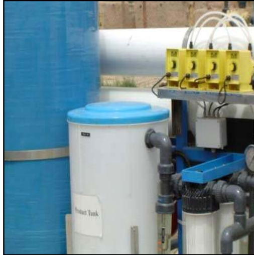
معدات جديدة للمياه في مشروع معالجة المياه الموجود في البصرة. الصورة: USAID
