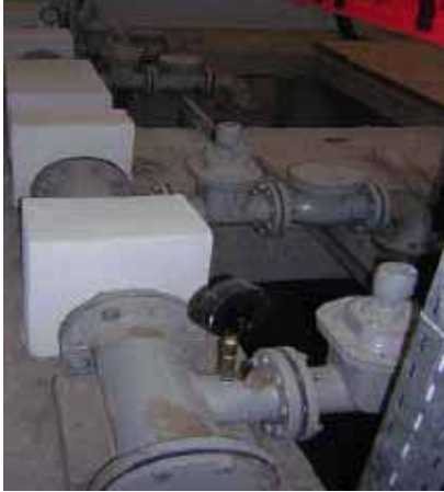
سيتم تحسين الخدمات لحوالي 1.8 مليون مواطن عند الانتهاء من الاصلاحات في نظام المجاري لأحد ضواحي بغداد الشمالية.
