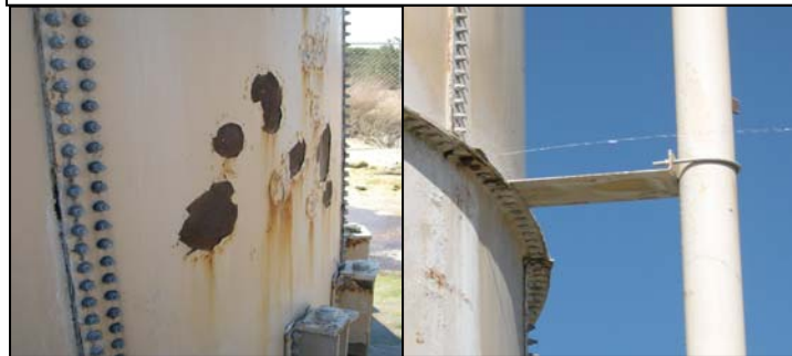
Campo Band of the Kumeyaay Nation, California, Izquierda; Ejemplo de la oxidación evidentemente en muchas partes del exterior del tanque. DERECHA: Ejemplo de fuga en el tanque
