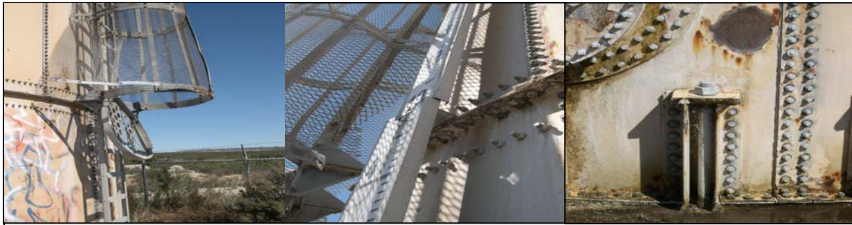
Campo Band of the Kumeyaay Nation, California; Izquierda: La escalera de la izquierda esta colgando de una cadena. Derecha: El indicador del nivel del agua esta descompuesto. Unos metros más arriba el indicador está completamente roto y algunas piezas fueron encontradas en el suelo.
