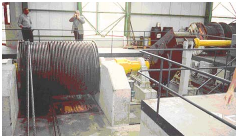
Figura 5. Compuertas deslizantes – sistema de malacate
