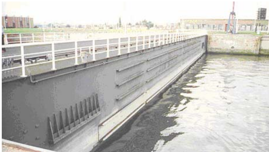
Figura 4. Compuerta deslizante en la esclusa de Berendrecht
