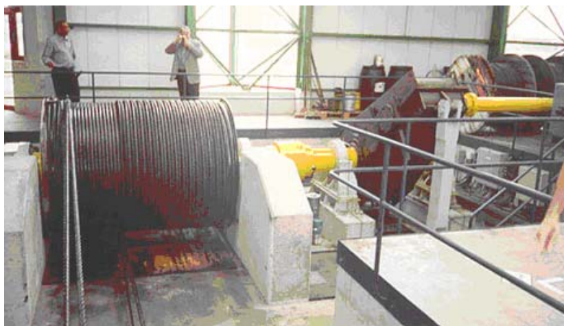
Figura 9. Compuertas deslizantes – sistema de malacate
