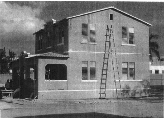
Edificio de oficinas administrativas en proceso de remodelación de la restaurada cárcel de San Pedro de Macorís.
