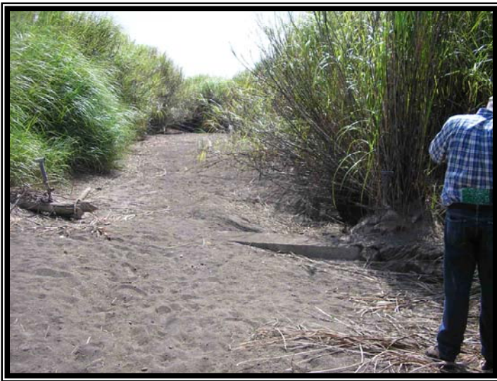
Foto 7. Sitio T6. Vialidad interna del Sitio T6 donde se aprecia la acumulación de sedimentos.
