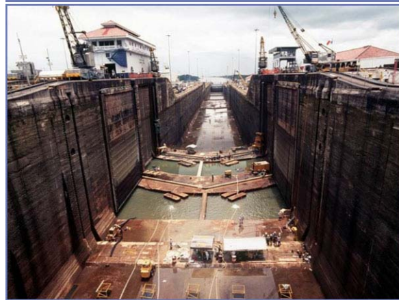
Figura A-57 El mantenimiento de cualquier esclusa saca de servicio a una de las vías del Canal. Lo que implica una reducción significativa en la capacidad de tránsito del Canal.
