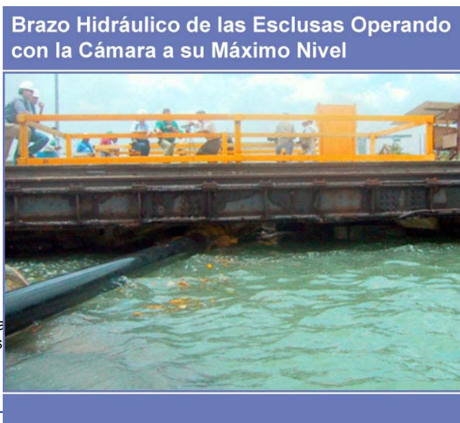
Figura 5-17 Brazo hidráulico que opera las compuertas con el sello para prevenir la entrada de agua por la elevación del nivel del lago Miraflores.
