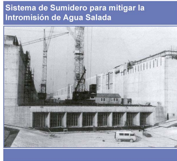
Figura 7-52 Sistema de mitigación de agua salada por medio de sumidero ( sump ) durante su construcción en las esclusas de Terneuzen, Países Bajos (Holanda), ha operado por más de 14 años.
