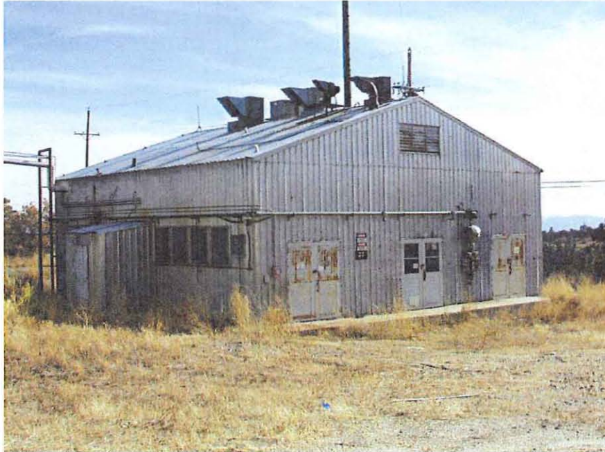
(LANL, RRES-ECO/HREPC, #PIC061-NW)
