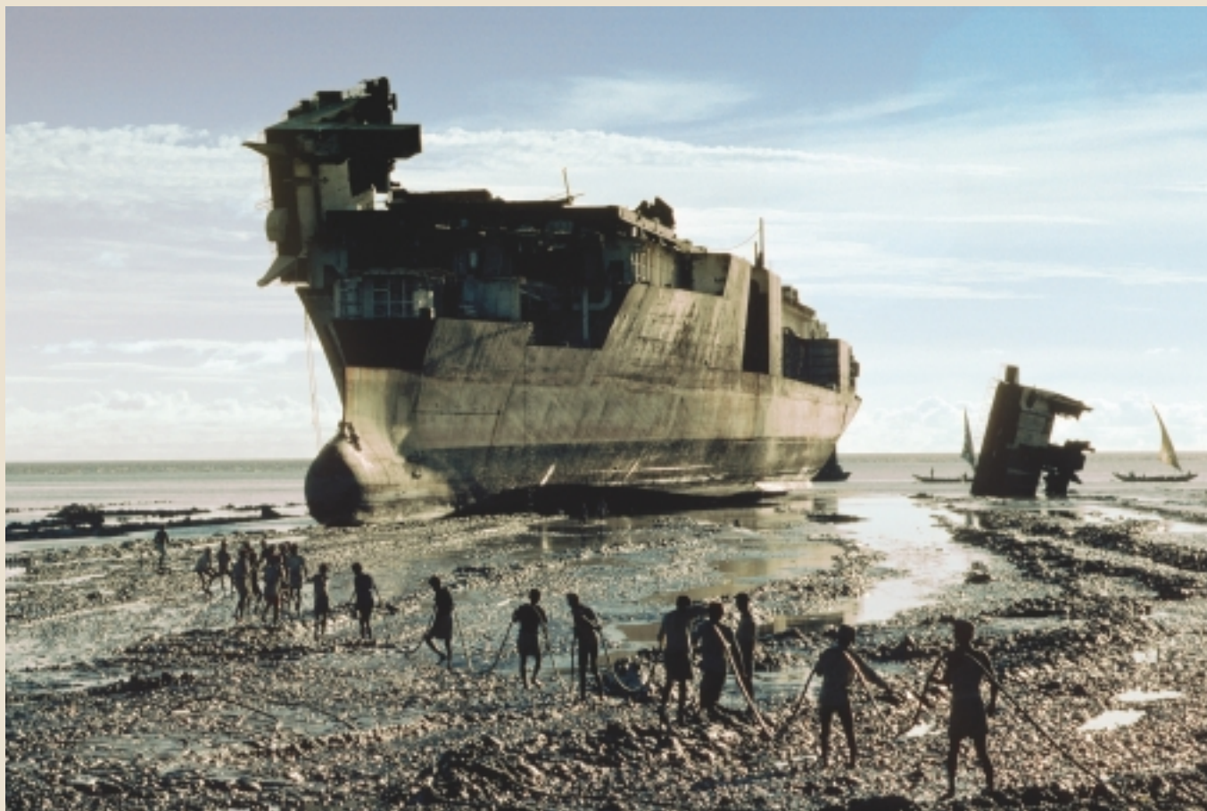
Tarea Hercúlea. Los desguazadores de barcos, como estos trabajadores cerca de Chittagong, a menudo carecen del equipo básico de protección personal y pueden enfrentar peligros tales como asbesto, gases tóxicos y explosiones.
