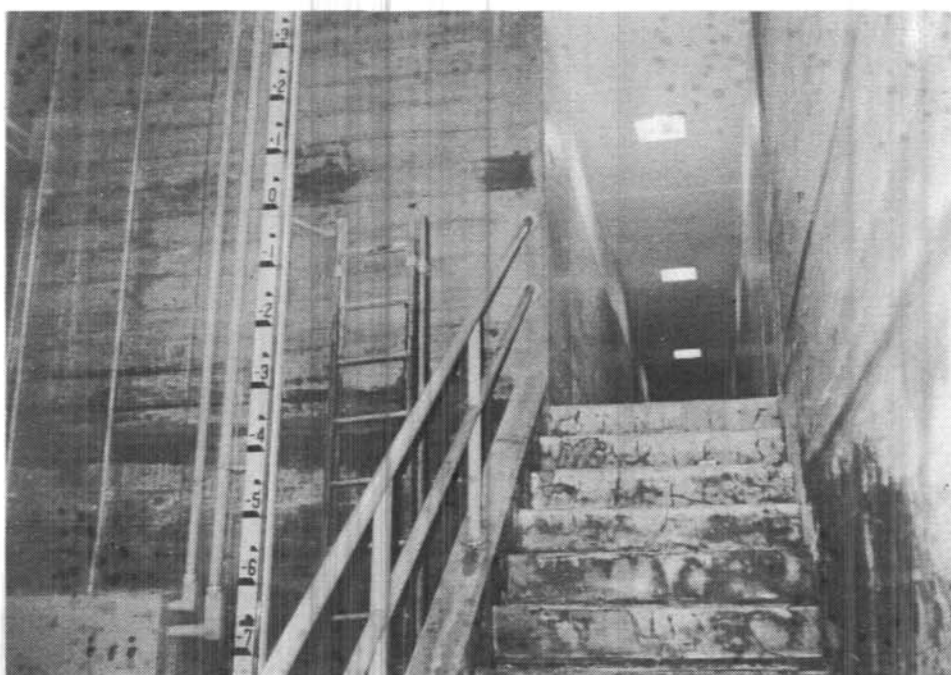
Foto 8.- Unidad 5 - El nivel del agua marcaba un poco más de -2 en el limnómetro en su punto más elevado. Se ve aquí que el nivel del agua alcanzaba unos 46 cm por encima del escalón superior 18/1/91
