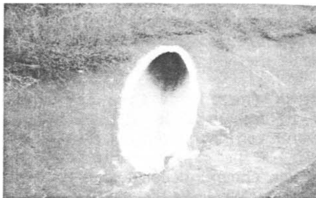
Figura 5.- La boca acabada de la tajea en la parte inferior del paramento de aguas abajo de la presa Enid.
