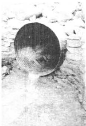
Figura 3.- Tajea de metal corrugado después de la limpieza, mostrando remiendos de alquitrán.
