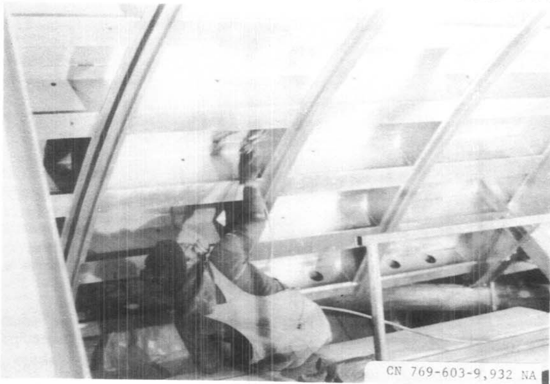
Foto 2.- Canal McCluskey. Aplicación de la capa selladora de aluminio vinilo al interior de la compuerta radial sur en New Johns Lake. 8/3/89
