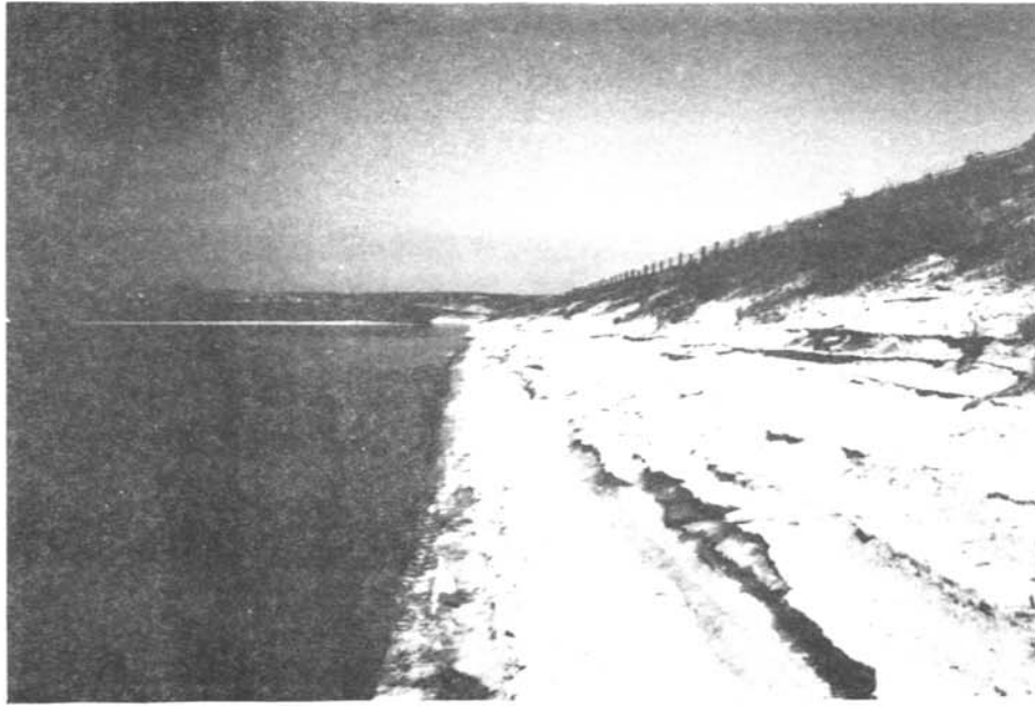
La presa Calamus - Protección de suelo cemento en el paramento de aguas arriba de la presa. 7/6/88
