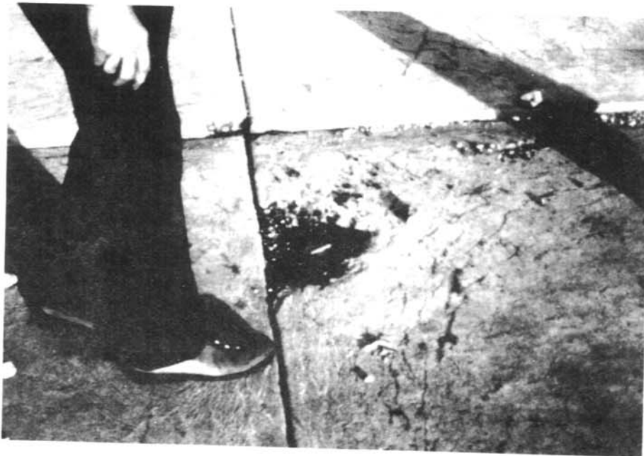
Foto No. 2.- La Presa de Webster. Ejemplo de grietas "D" presentes en muchas lozas. 10/72
