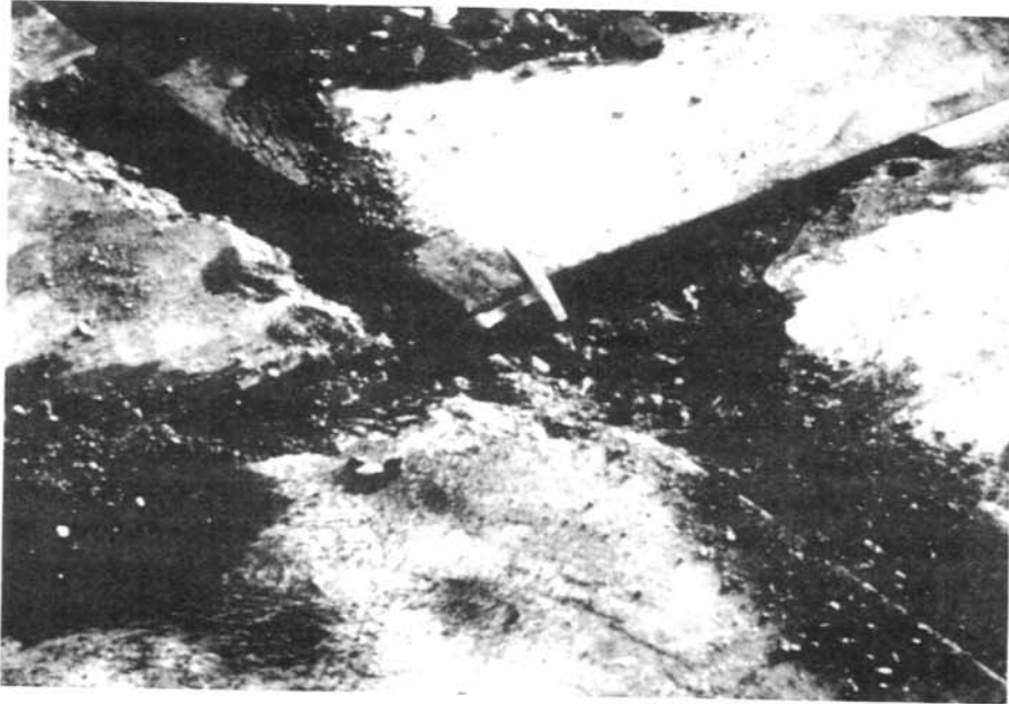
Foto No. 1.- La Presa de Webster. Ejemplo de extremo deterioro localizado. 10/72
