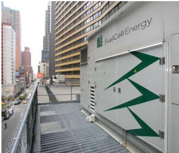
Топливный элемент мощностью 250 кВт, входящий в состав системы, обеспечивающей электроэнергоснабжение и горячее водоснабжение гостиницы «Шератон» в Нью-Йорке.
