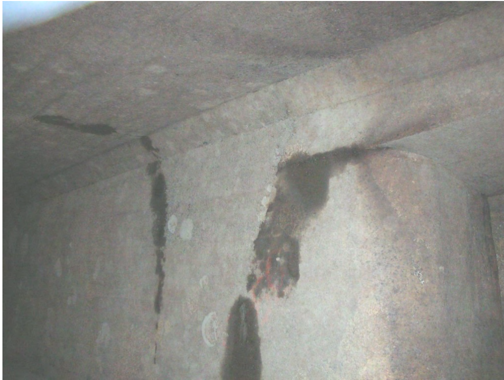
CS-1 Concrete Crack
