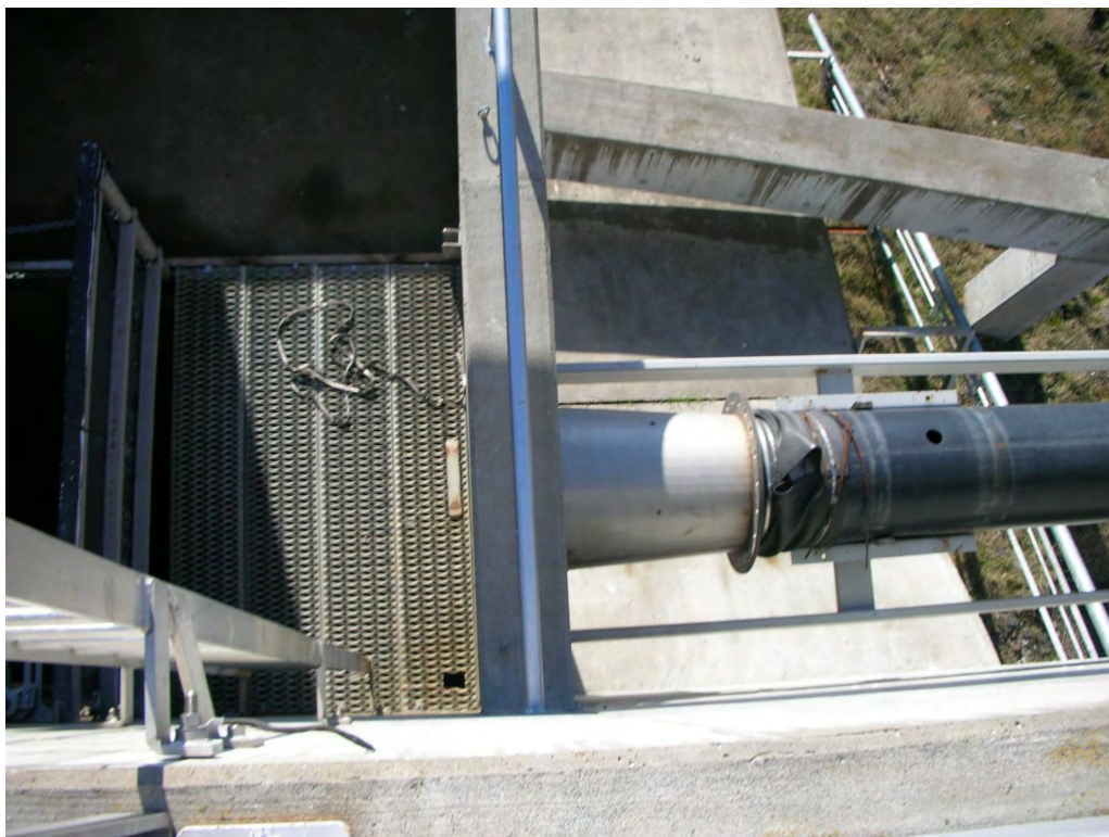
CS-4 Fish Bypass Pipe
