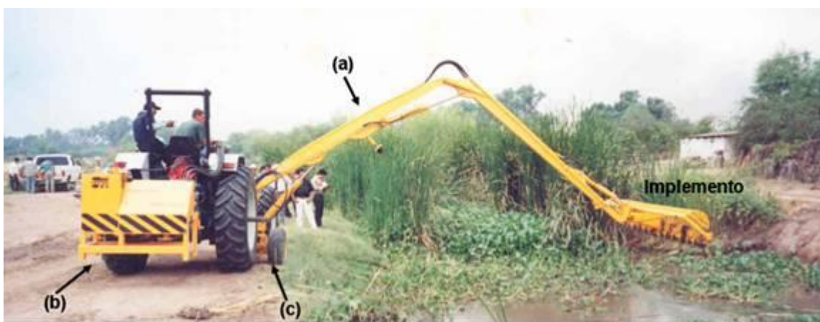
Foto 1. Equipo ligero para el mantenimiento de canales y drenes
