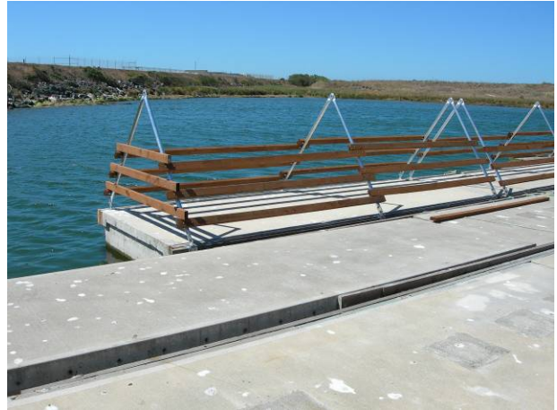
B. A-frame barrier.
