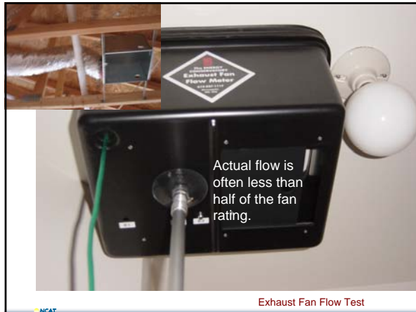
Exhaust Fan Flow Test
