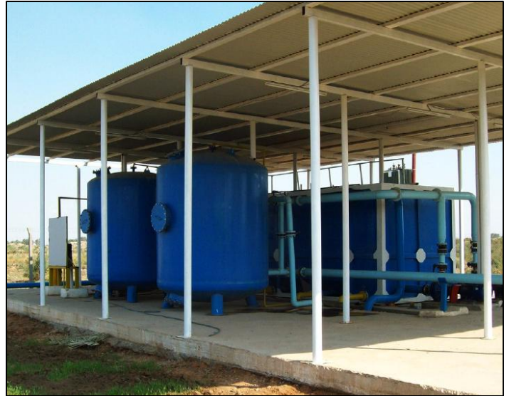
سوف يتم استخدام وحدة جديدة لمعالجة المياه لتوفير ماء الشرب النظيف الى ابناء محافظة القادسية
