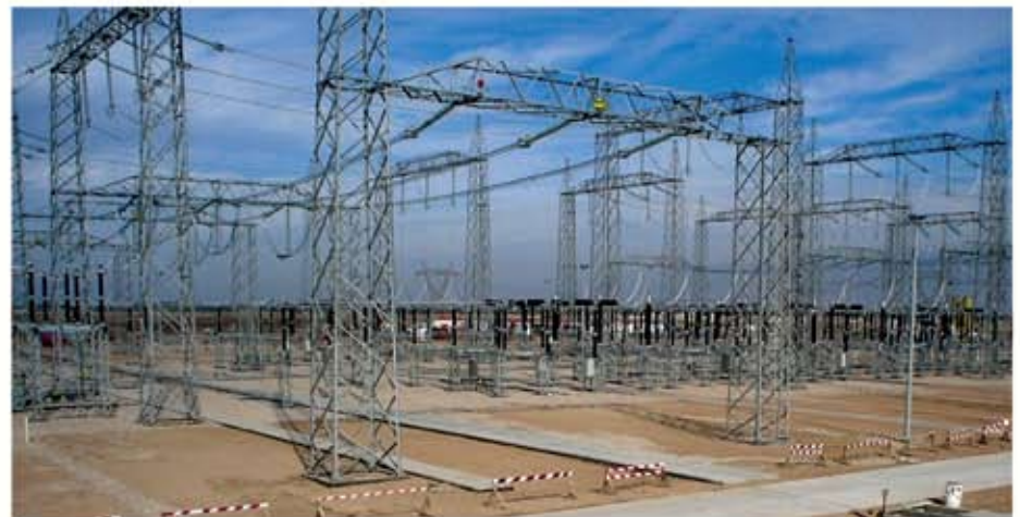
ابراج النقل في محطة العمارة (400 كيلو فولت) تسهم في تحسين شبكة توزيع الكهرباء في المدينة. تصوير أ. البحراني
