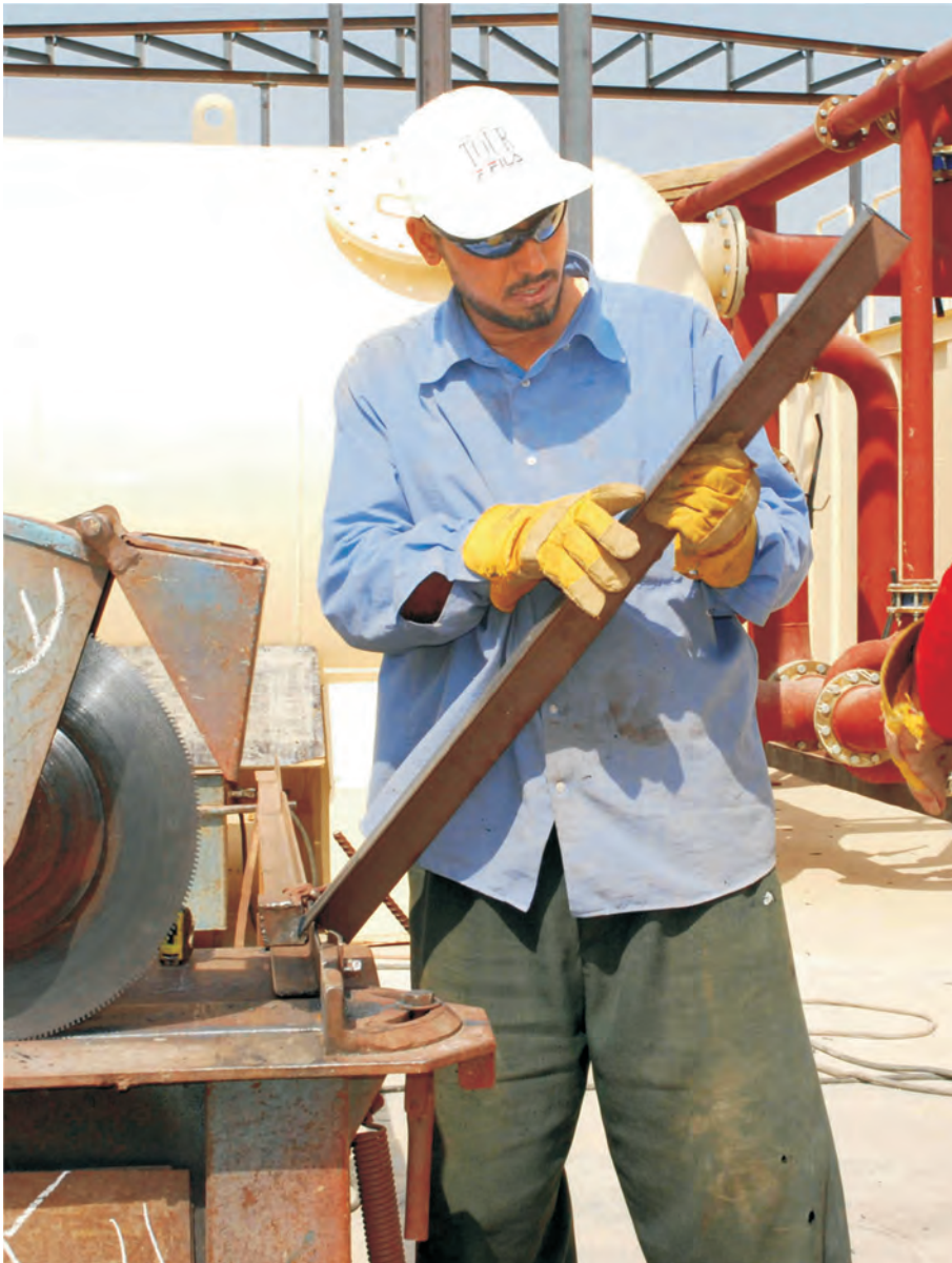
عامل عراقي يمارس عمله في محطة مياه جنوبي العراق تشرف على بنائها ثلاث نساء.
