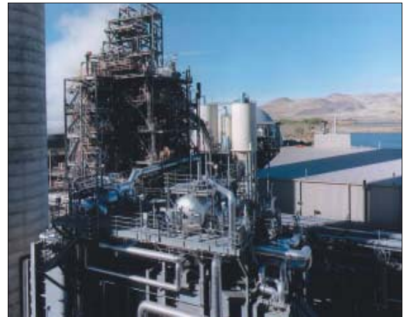
HRSG in foreground and gasifier island in background.
