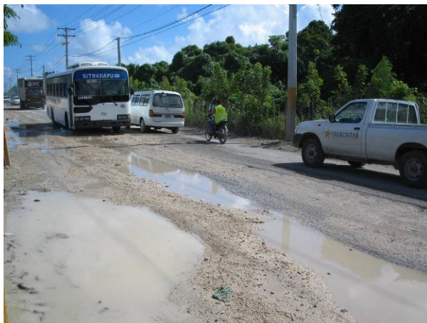
HOYOS Y ZANJAS IMPIDEN UN TRANSUTO FLUIDO EN LOS CAMINOS DE LA ZONA Y AFECTAN LA IMAGEN TURISTICA DEL DESTINO
