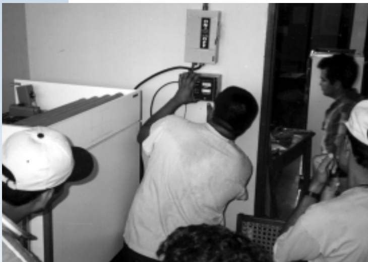
Figura 4.3. Un curso de técnicos fotovoltaicos completa la lista de comprobación de la instalación final antes de encargar un refrigerador/congelador en la clínica de la comunidad de Mulukuku,
