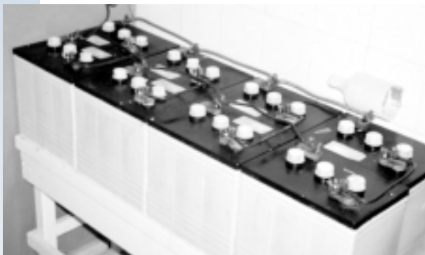
Figura 2.6. Un banco de baterías de plomo de ciclo profundo para operar un refrigerador de vacunas 24 horas al día. Los paneles fotovoltaicos o el generador de viento puede recargar las baterías.
