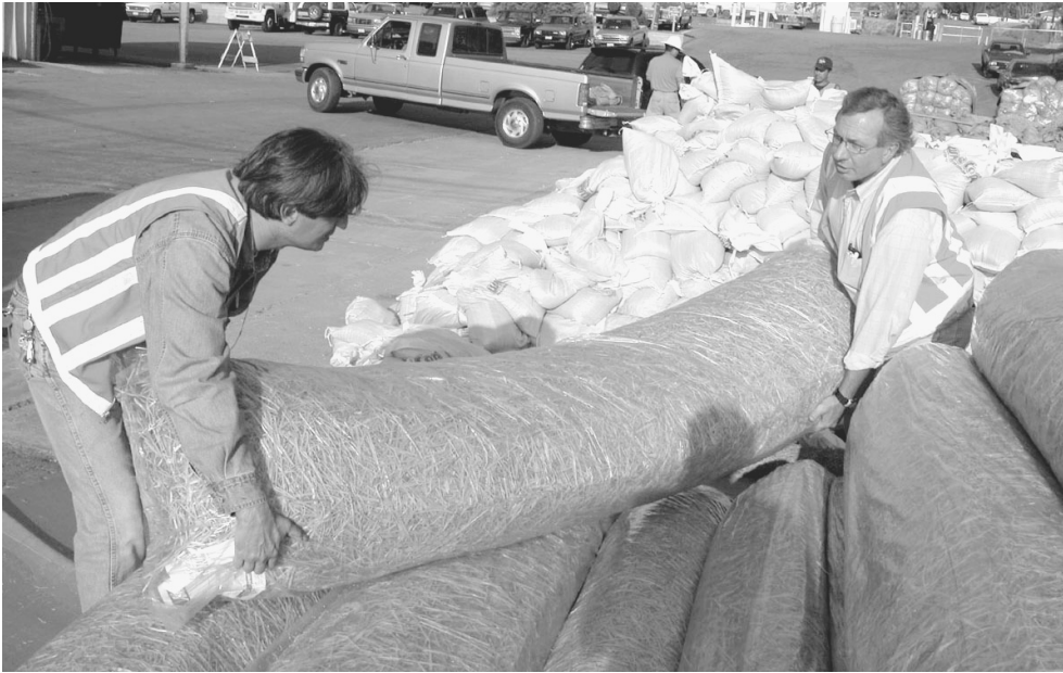
Trabajadores en el centro de erosión de Ramona cargan al vehículo de un residente una alfombra especial para desvío de inundaciones. Fotografía de FEMA por Michael Raphael.
