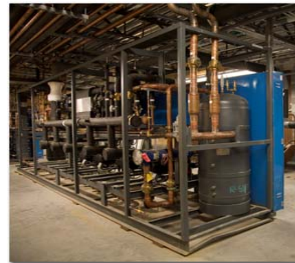
SNMT Med Temp Secondary Systems
