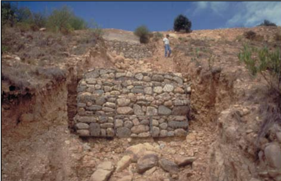
Foto 14.3 Una estructura costosa pero inútil de gaviones de control de formación de quebradas, que no se anclaron debidamente en las márgenes de las mismas, y tampoco se mantuvo el flujo por encima de la parte media protegida por la estructura.
