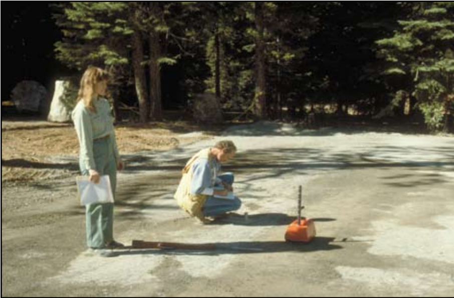
Foto 12.6 Uso de un “ densímetro nuclear ” para verificar la densidad del agregado. Realice control de calidad durante la construcción, tales como pruebas de granulometría y de peso volumétrico, entre otras, para lograr las propiedades esperadas de los materiales, para el proyecto en cuestión.
