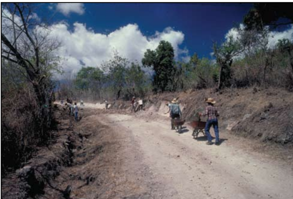
Foto 4.7 Aplique las técnicas de construcción de caminos que sean más costo-efectivas en cuanto a costo para el proyecto y el área geográfica en particular. La comparación de la mano de obra contra el uso de equipo depende de los costos, la disponibilidad del equipo y las tasas de producción.
