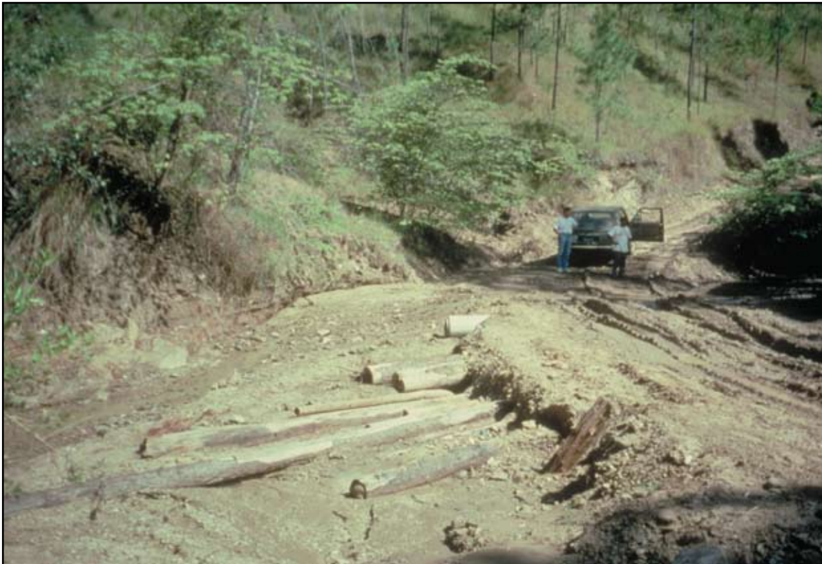
Foto 8.10 La mayoría de las alcantarillas de troncos tienen una capacidad de flujo muy limitada. Retire las alcantarillas provisionales de troncos (Tipo Humboldt) antes de tormentas fuertes o de la temporada de lluvias.
