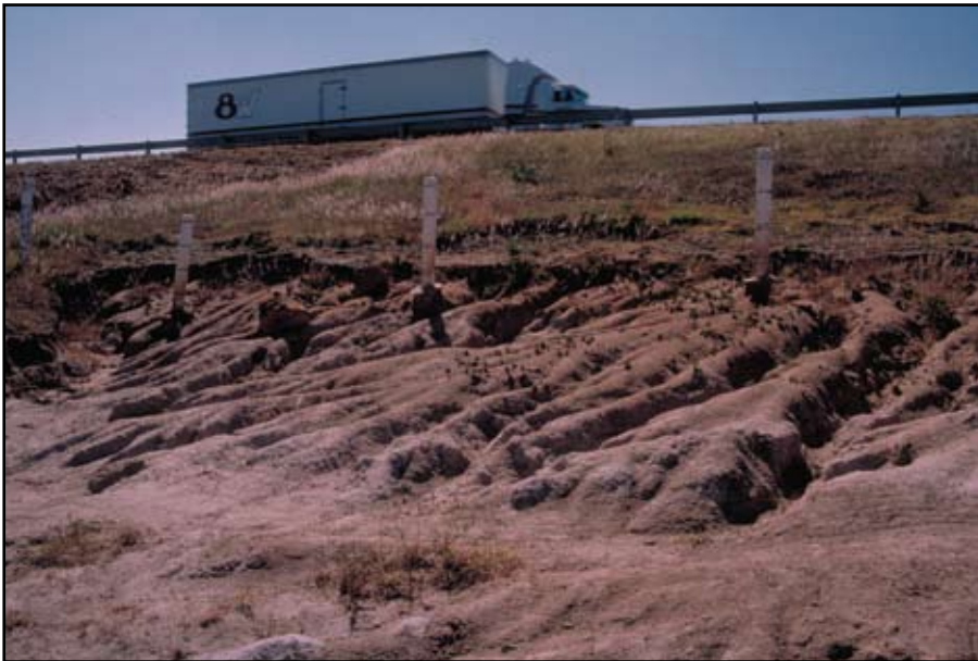
Foto 13.2 Erosión producida en un talud adyacente a una carretera, debida a la falta de vegetación o a un inadecuado uso del suelo. Observe que la vegetación está evitando la erosión junto a la carretera.
