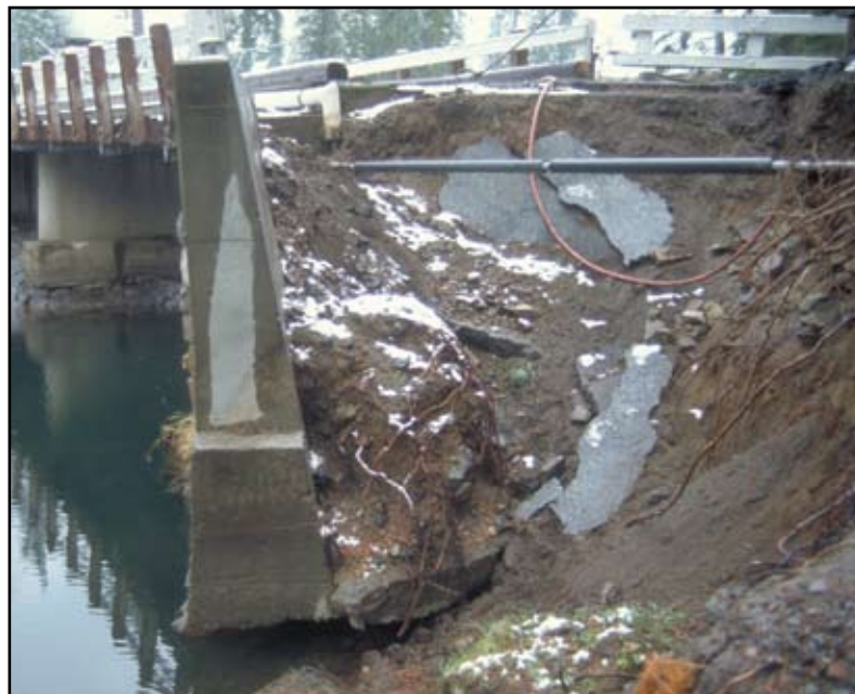
Foto 6.1 Socavación de un suelo fino detrás del estribo de un puente, causada por una protección insuficiente de las márgenes del arroyo durante una tormenta.
