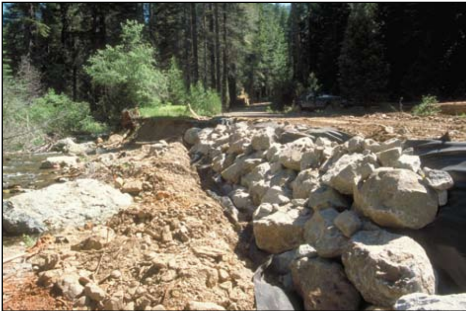
Foto 6.7 Un enrocamiento de protección con respaldo de un filtro de geotextil están siendo usados para proteger al camino de grandes flujos de agua. Observe que el camino está mal ubicado, muy cerca del arroyo.
