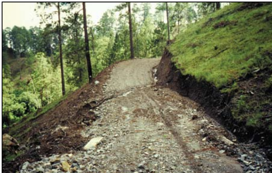
Foto 4.3 Evite la construcción de caminos con pendientes fuertes o en laderas empinadas. Resulta difícil controlar el drenaje cuando la pendiente del camino es muy pronunciada.
