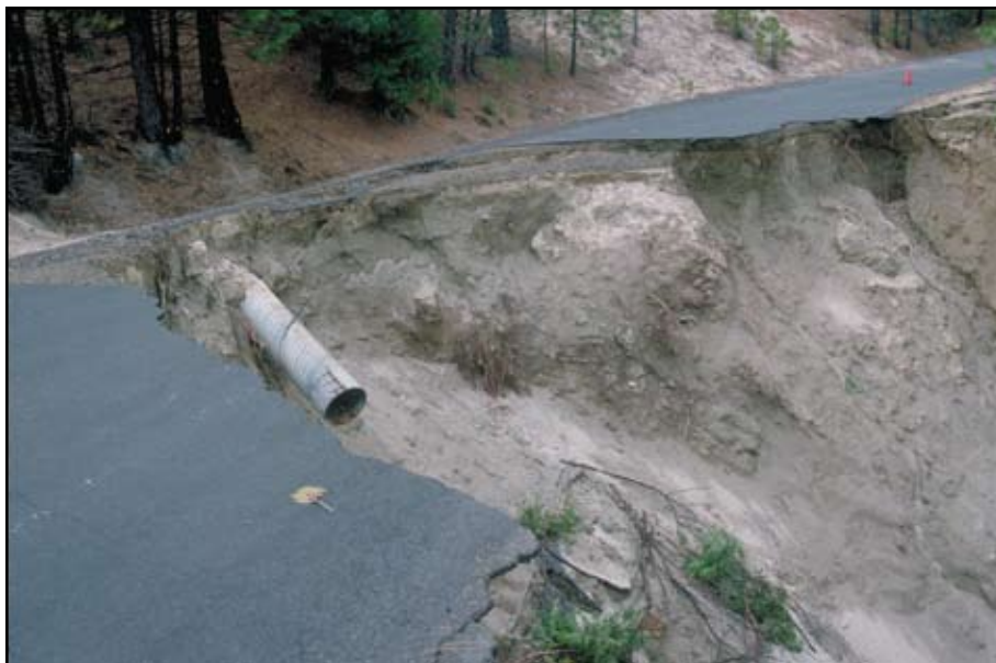
Foto 11.10 Falla del relleno de un camino en terreno escarpado, para el que ahora se requiere una estructura de contención o un corte alto para retener o ampliar el camino alrededor de la falla.
