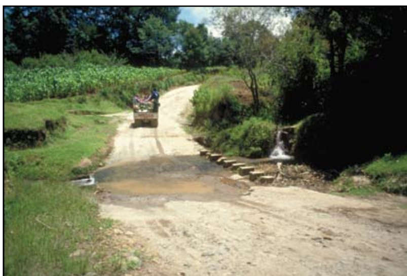
Foto 9.1 Use cruces revestidos para temporadas de estiaje o vados con la mayor frecuencia posible, para cruzar caudales bajos en desagües naturales anchos y poco profundos para evitar el uso de tubos. Note que la superficie de este cruce requiere reparación.
