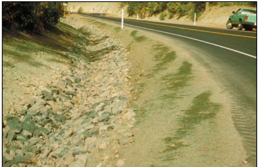
Foto 3.5 Se deberá dar mantenimiento a los caminos y a las obras de drenaje para resistir los efectos de grandes tormentas con una erosión mínima, por ejemplo con enrocamientos de protección en las cunetas, las cuales deben mantenerse limpias.
