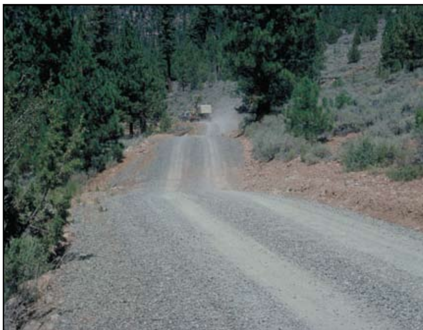
Foto 7.1 Diseñe los caminos para que eliminen el agua rápidamente de la superficie de rodadura y minimicen las concentraciones de agua, mediante el uso de peralte hacia afuera, hacia adentro o coronamientos y agregue pendientes ondulantes.
