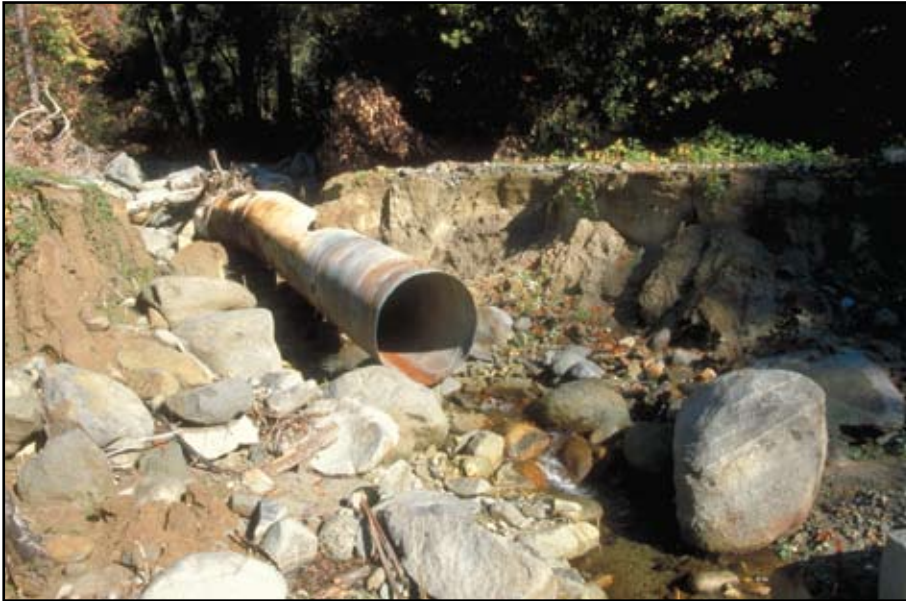
Foto 8.2 Falla de una alcantarilla debido a una capacidad de flujo insuficiente o tamaño inadecuado del tubo para dejar pasar escombros (boleos) encontrados en el drenaje.
