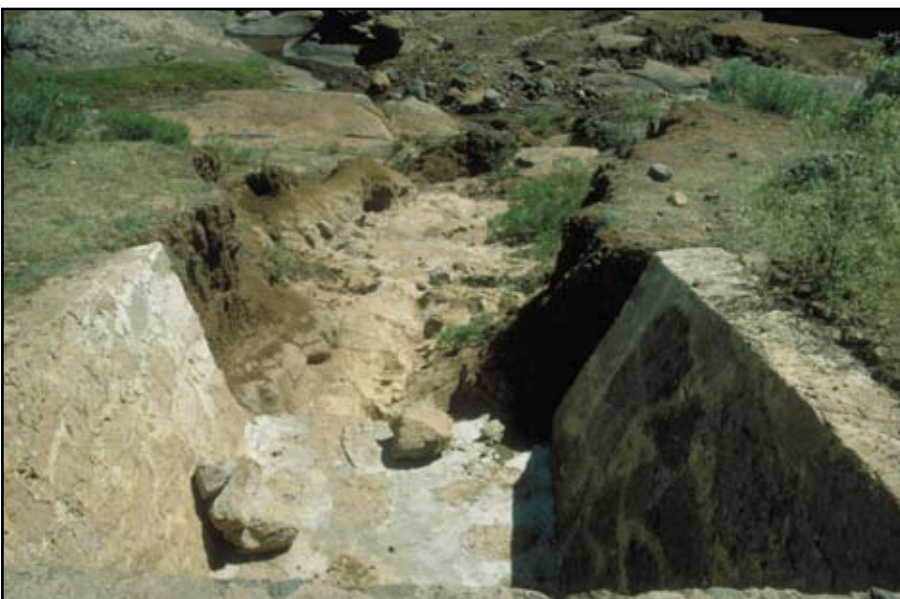
Foto 7.4 Agregue protección a la salida del drenaje y/o disipadores de energía, para evitar la erosión y formación de quebradas aguas abajo de la estructura protegida.
