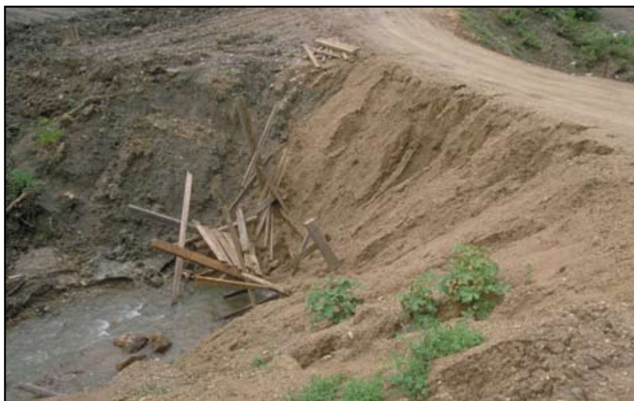
Foto 11.4 Evite taludes de terraplén sueltos y excesivamente escarpados (con inclinaciones arriba de 1\frac{1}{2}:1 ), sobre todo a lo largo de arroyos y cruces de agua.
