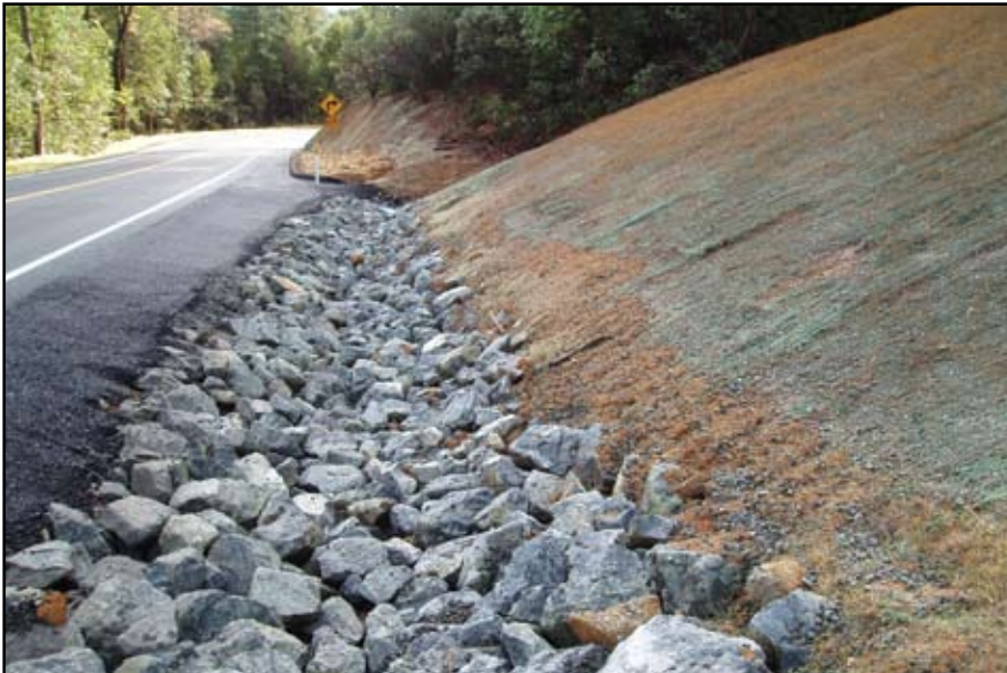
Foto 13.5 Cuneta a un lado del camino, revestida con rocas bien graduadas para el control de la erosión.
