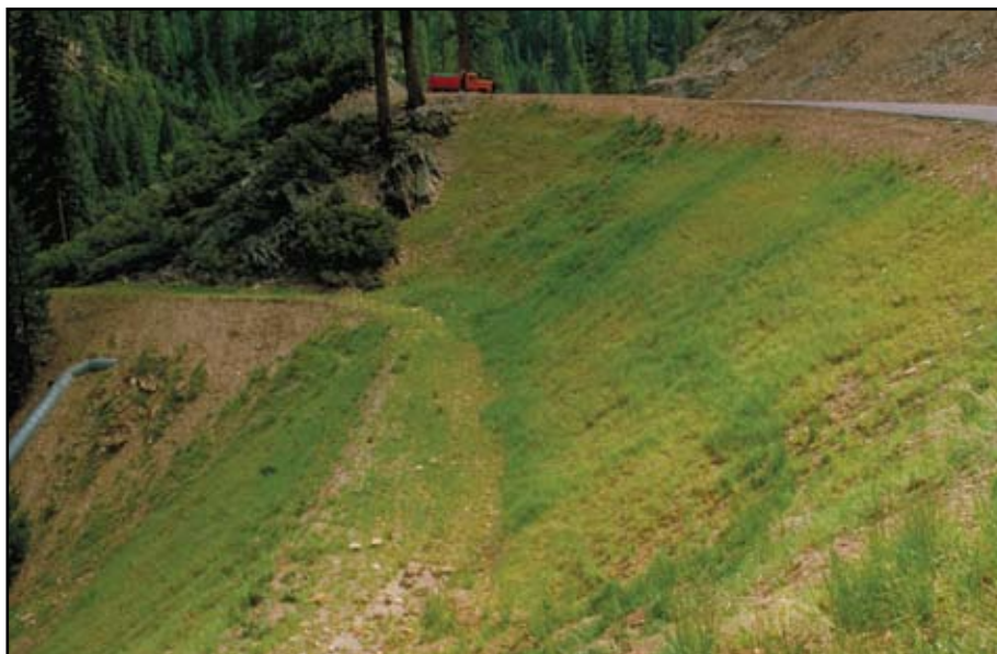
Foto 11.5 Construya los taludes de terraplenes con una inclinación de 1 ½:1 o más tendidos, para promover el crecimiento de la vegetación y estabilizar la superficie.
