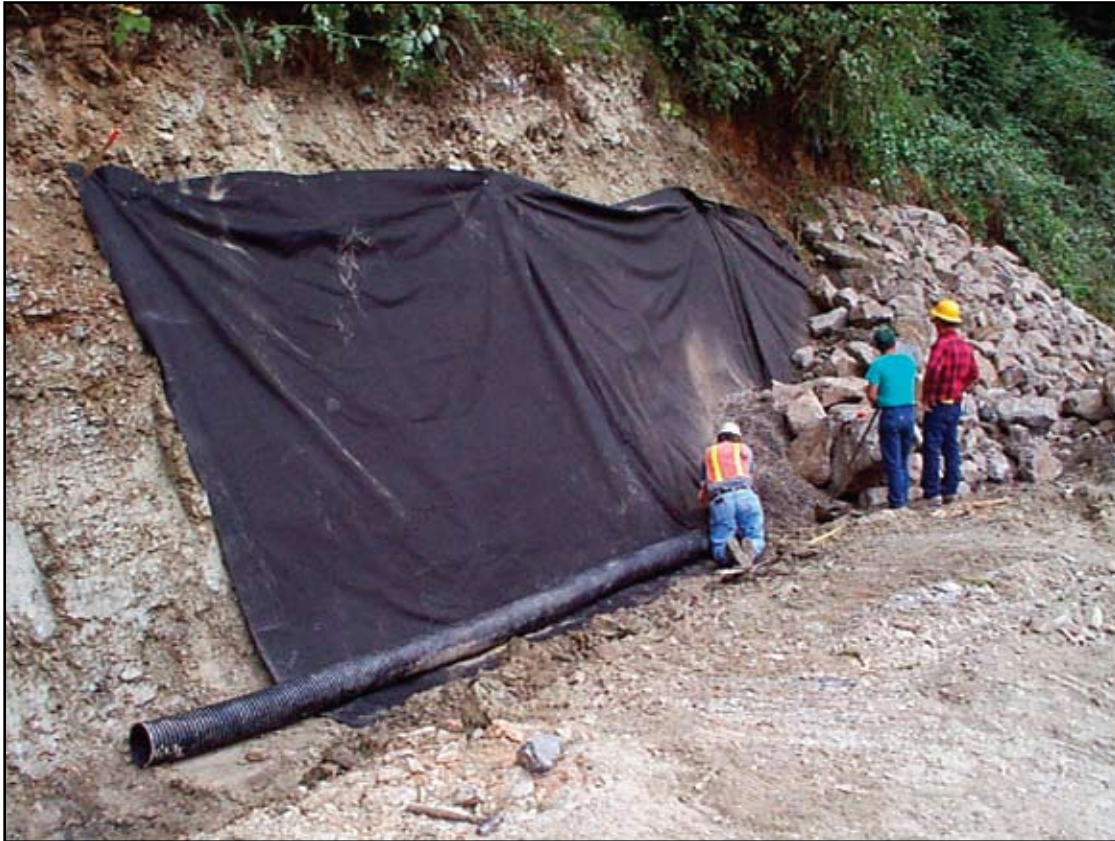
Foto 6.5 Tela de filtro (geotextil) como respaldo de un contrafuerte de talud, hecho con roca suelta que se usa para proporcionar filtración, permitir la infiltración y evitar el desplazamiento del suelo fino hacia la roca (Foto de Richard Van Dyke).
