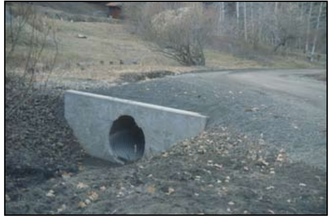
Foto 4.6 Una alcantarilla bien diseñada e instalada con muros de cabecera, para mejorar la eficiencia y para la protección o retención del material de relleno.
