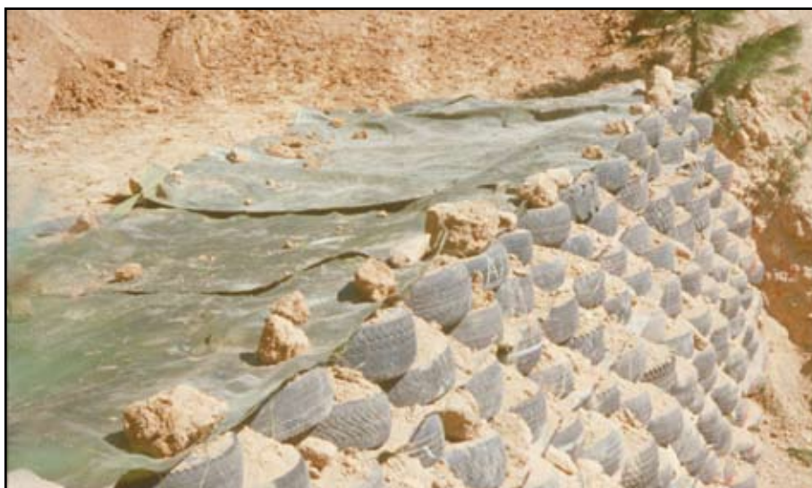
Foto 11.11 Muro de contención de tierra estabilizada mecánicamente (MSE), como Tierra Armada con la fachada protegida con llantas y con capas de refuerzo de geotextiles. Se usa para ampliar el camino en una zona con fallas en el terreno. Las estructuras tipo MSE son a menudo las estructuras de contención menos costosas disponibles. También se usan a menudo muros de malla de alambre soldado.
