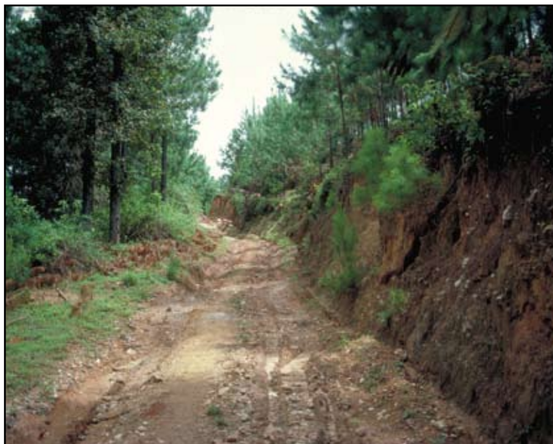
Foto 12.1 Camino con roderas causadas ya sea por un suelo blando de subrasante o por drenaje inadecuado del camino (o ambos).
