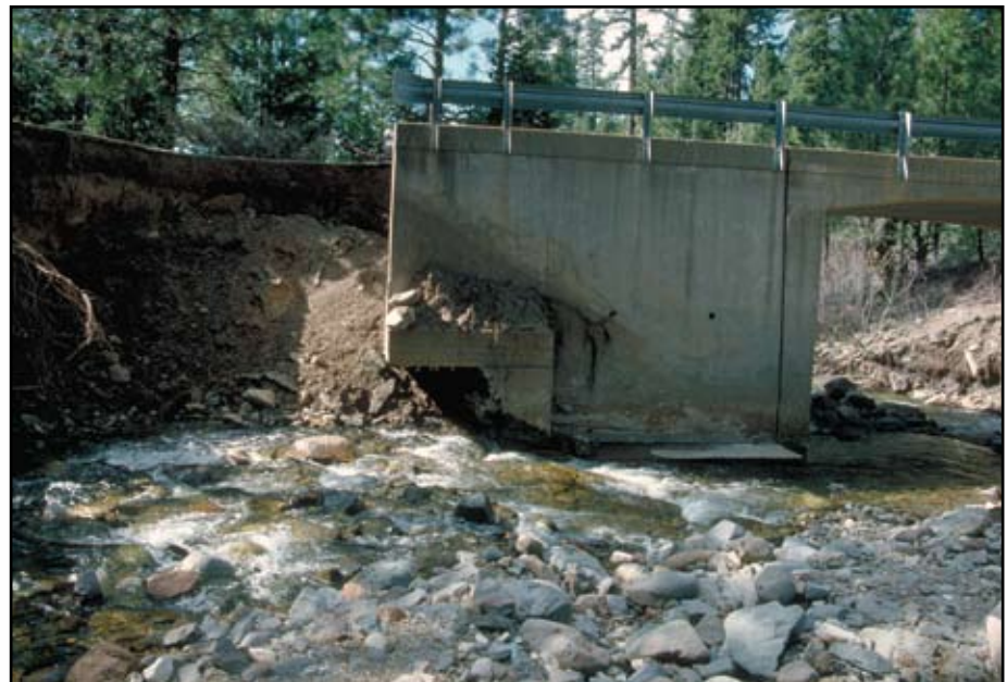
Foto 10.3 La socavación es una de las causas más comunes de falla de puentes. Use un claro lo suficientemente ancho para minimizar la constricción del canal natural. Ubique la cimentación del puente sobre roca sana siempre que sea posible, o por debajo de la profundidad de socavación, y recurra a medidas de protección de las márgenes, tales como enrocamiento, a fin de evitar la socavación.
