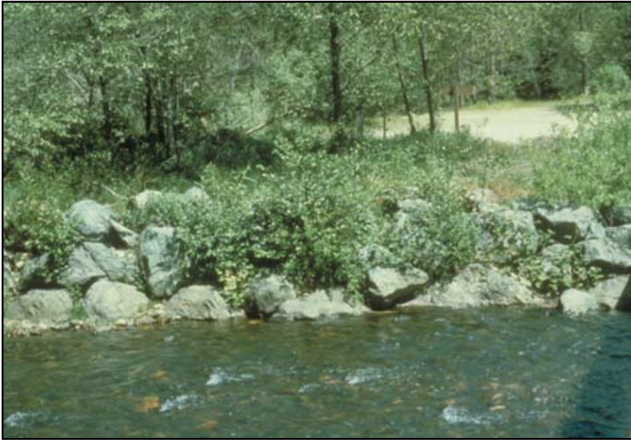
Foto 6.2 Enrocamiento usado para la protección de márgenes del arroyo contra la socavación a la entrada de una estructura. Observe el empleo de sauces para aumentar la resistencia “biotécnica” derivada de las raíces.
