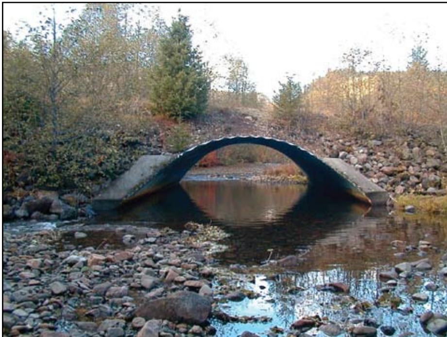
Foto 2.3 Alcantarilla en arco sin fondo que cubre la mayor parte del claro del cauce del arroyo, mantiene inalterado el fondo natural del arroyo, minimiza los impactos al sitio y ayuda a promover la migración de peces. (Foto proporcionada por S. Wilson-Musser).
