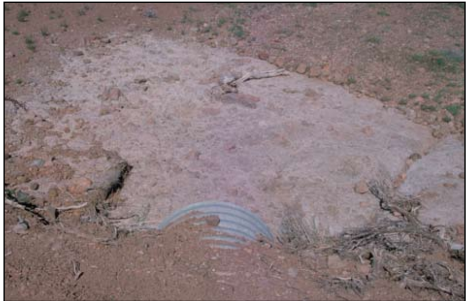
Foto 7.5 Proteja la descarga del tubo de alcantarilla y los drenes de vados superficiales mediante enrocamiento o un vertedero de protección de mampostería, o seleccione áreas con roca sana o con vegetación densa.
