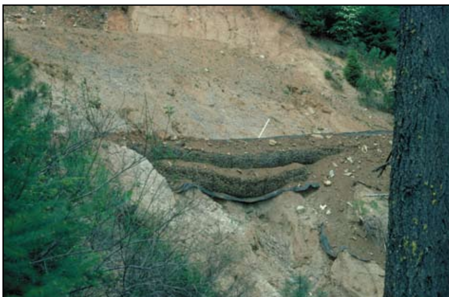
Foto 11.12 Una estructura de gaviones que fallará pronto debido a la falta de una cimentación adecuada. Todas las estructuras de retención, ya sean MSE o muros de gravedad, requieren una buena cimentación.
