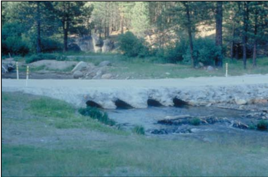
Foto 9.2 Un vado con alcantarillas, usando tubos múltiples de alcantarillas para desalojar el flujo a través de los mismos y mantener a los vehículos fuera del agua, pero que dejan pasar sobre toda la estructura los flujos grandes y los escombros.
