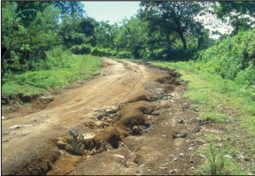
Foto 1.2 Camino con drenaje inadecuado que tiene una superficie de rodadura rugosa para los usuarios, es una fuente de contaminación para sedimentos, y resulta relativamente costosa para darle mantenimiento.
