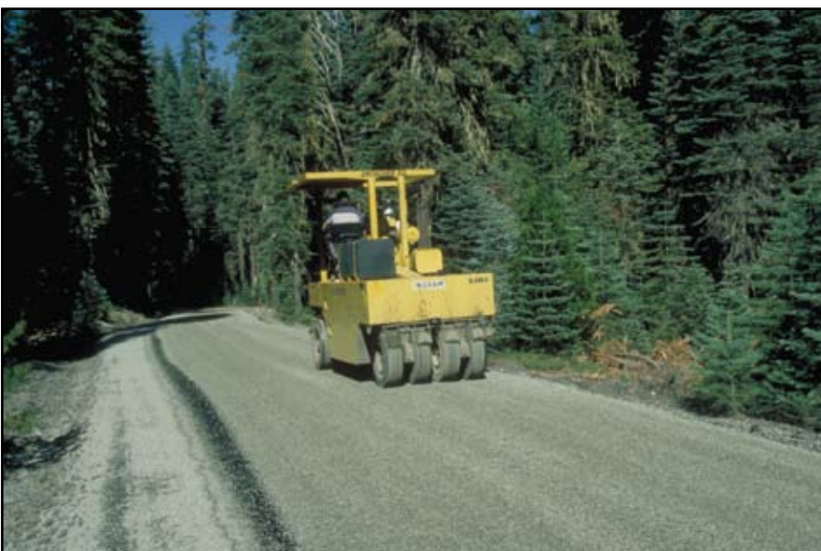
Foto 12.8 Compactación de una superficie con aplicación de riego de sello. Se puede usar una gran variedad de materiales de recubrimiento, dependiendo de su disponibilidad, costo y desempeño.
