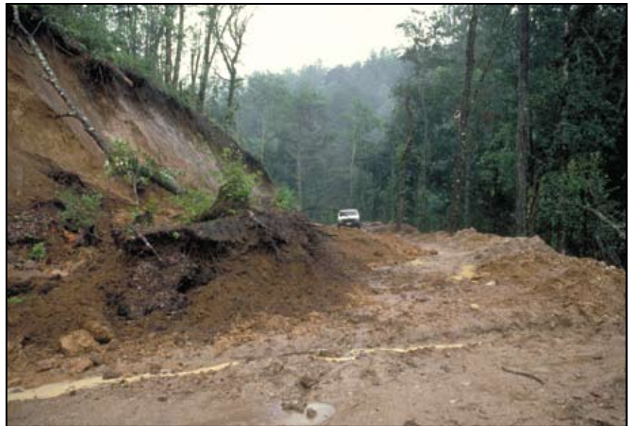
Foto 1.3 Camino problemático debido a fallas en los cortes del camino. Los problemas de inestabilidad ocasionan retrasos en los usuarios del camino y altos costos de mantenimiento o de reparación.
