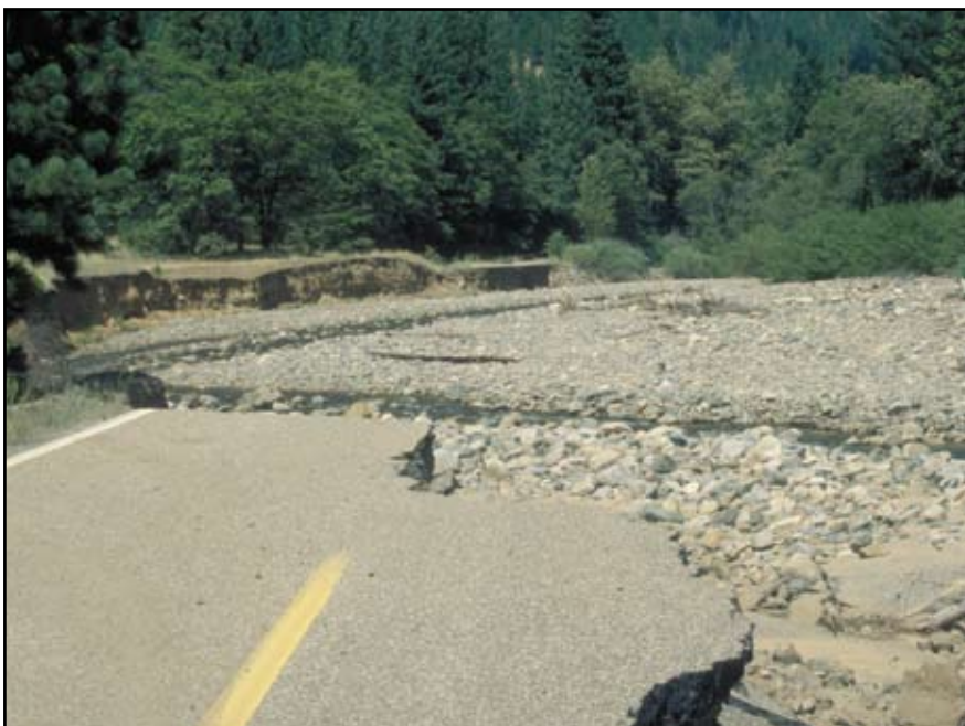
Foto 3.3 Un camino mal ubicado, en la peligrosa llanura de inundación de un río, que ha sido barrido durante una tormenta de impacto tremendo.
