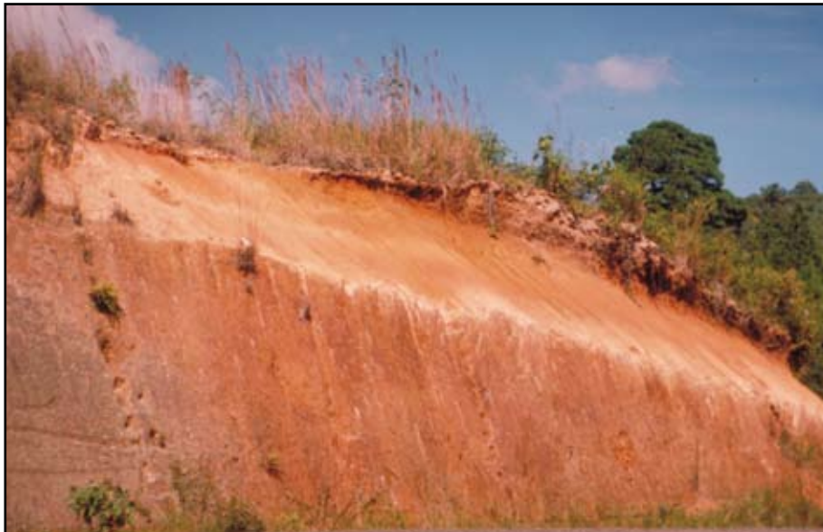
Foto 11.2 Construya los taludes de corte con inclinaciones de \frac{3}{4}:1 o más tendidos en la mayor parte de los suelos, para lograr estabilidad a largo plazo. En suelos muy cementados y en roca (parte inferior del corte), un talud de \frac{1}{4}:1 resultará generalmente estable.
