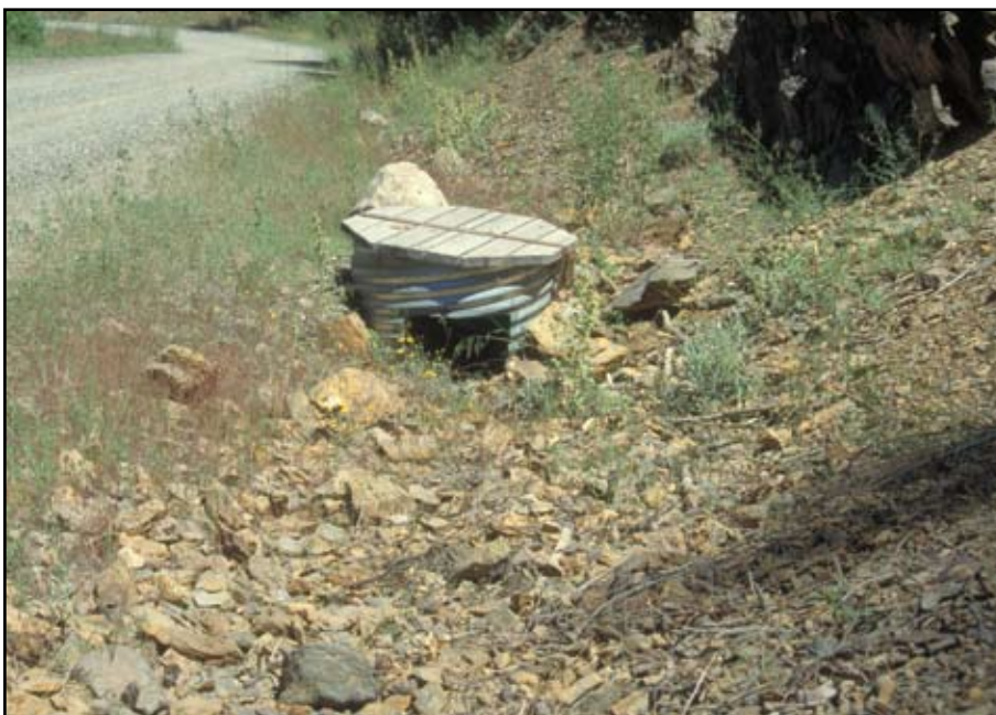
Foto 7.7 Cuneta protegida con enrocamiento y boca de caída para controlar el agua y evitar la socavación de la cuneta.
