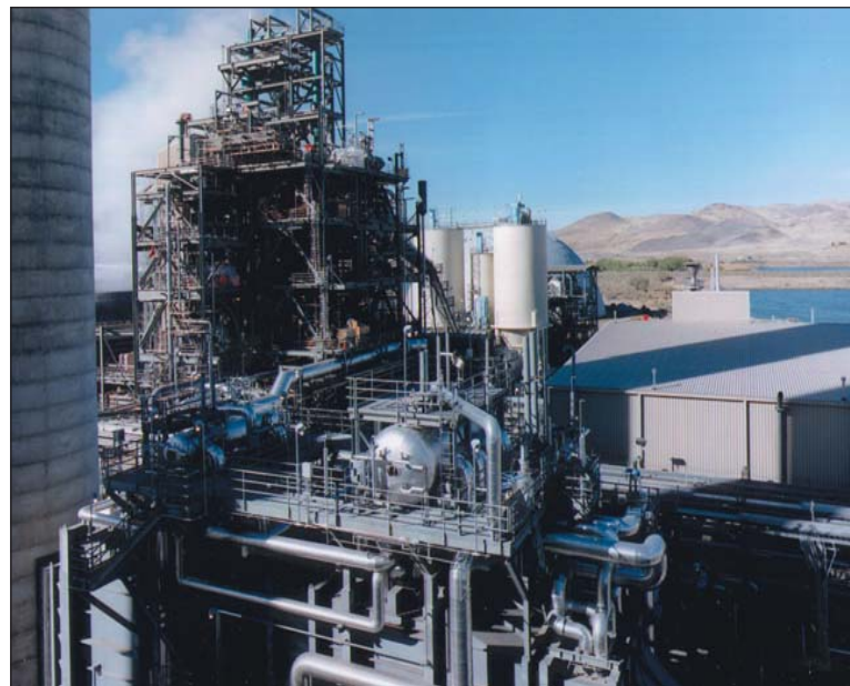
HRSG in foreground and gasifier island in background.
