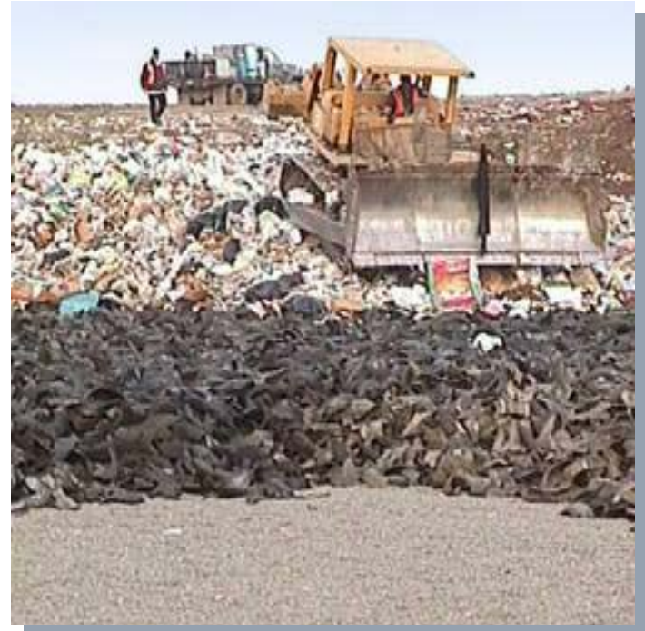
Filling Bioreactor Landfill
