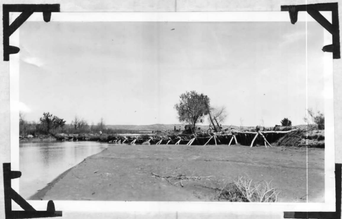
Río Grande.- Diversion dam at Haciendita, Texas.
