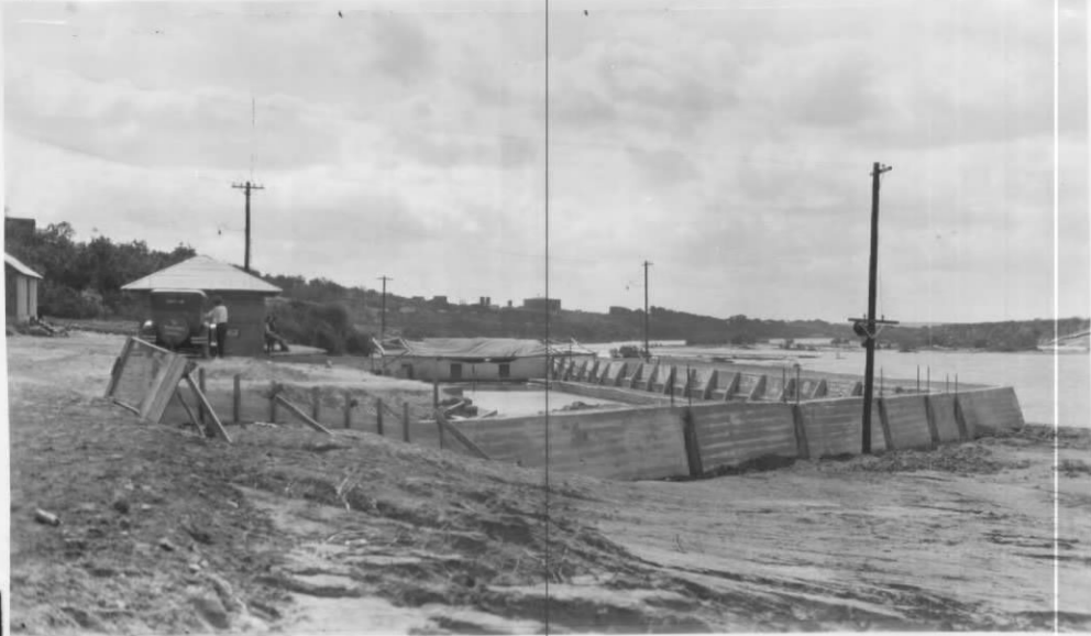
Vista que muestra los muros de concreto del balneario construido en el cauce del Río Bravo en Laredo, Texas.
