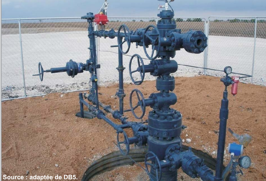
Figure 15.3 Tête de puits
